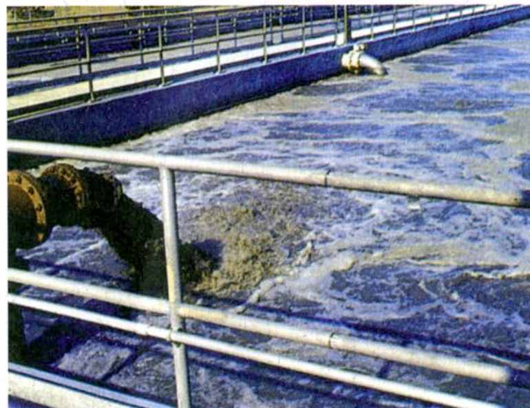
Tanque de aeración en operación. La tubería color óxido en primer plano es el tubo de admisión para reciclar el fango activado del clarificador secundario.
