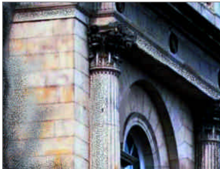
Daños en los edificios causados por los agentes contaminadores del aire
